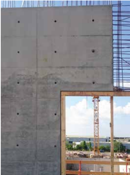
► Dunkelverfärbungen bei Sichtbetonoberflächen unter Verwendung unterschiedlicher Betonrezepturen / Dark discoloration on exposed concrete surfaces using different concrete formulations
